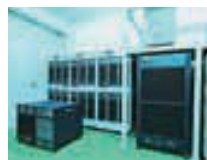
第2電源高調波室
